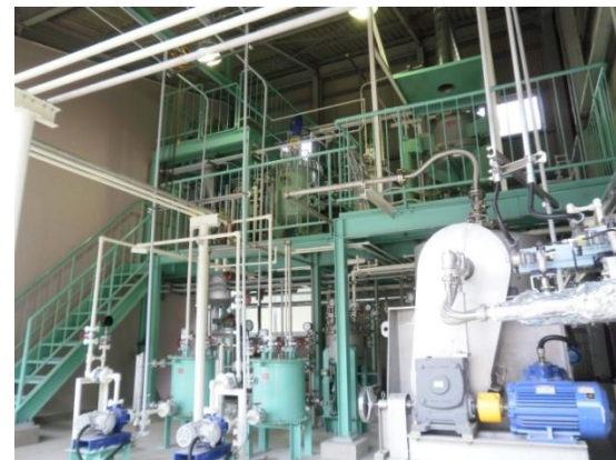
木質バイオマスのパイロットプラント
