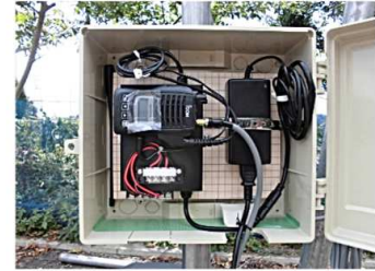
受信側ケース内部
