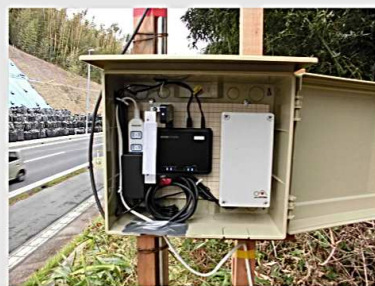
データ収集ユニット 実装・設置状況
