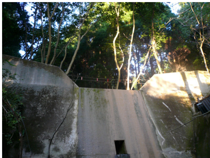
ワイヤーセンサー設置例(堰堤上、堆積物下部)
